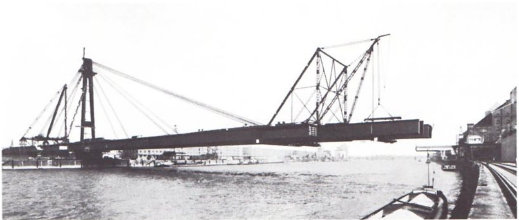
Abb. 93 verdeutlicht aus der Bauphase des Freivorbaus, daß die gesamte Eigenlast des Balkens über die Schrägseile zum Pylon umgelenkt und von dort sowohl durch den Pylon selbst als auch über die Seilrückverankerung ins Erdreich abgeleitet wird. Das Auflegen des Balkens auf den Ludwigshafener Uferpfeiler ergibt innerhalb des Balkens andere statische Verhältnisse, als sie in der wiedergegebenen Baustufe bestehen.
