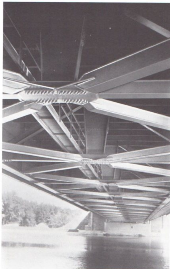
Abb. 97 Ein Blick unter die Brücke zeigt, daß die Konstrukteure hier alle Konstruktionsnotwendigkeiten besonders auch im Hinblick auf die horizontalen Kräfte unter die Fahrbahn legten.
