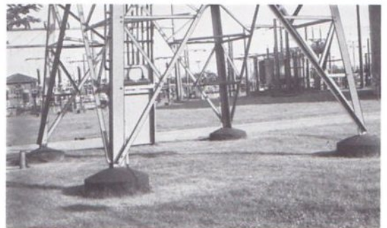
Abb. 292 Die Gründung eines Endabspannmastes des E-Werks in Mannheim-Käfertal. Siehe auch hierzu die Abb. 301 und 302.
