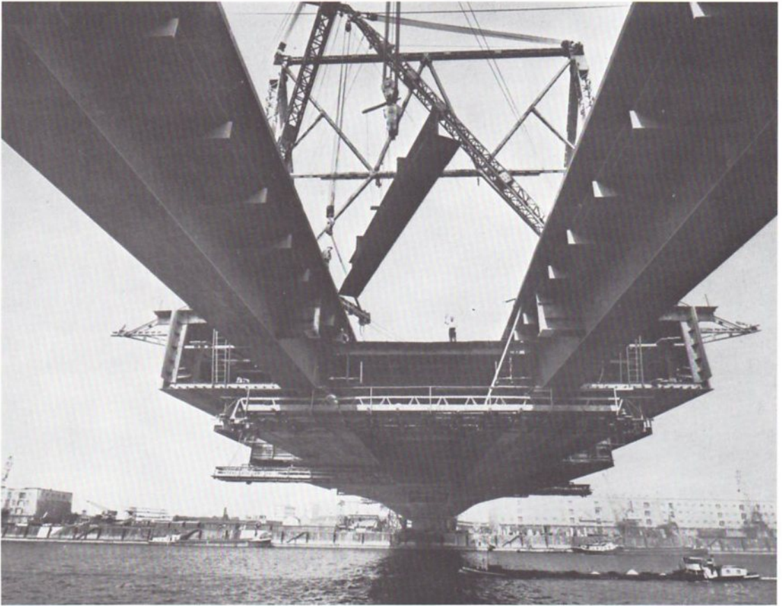
Abb. 94 Die vor dem Ludwigshafener Uferpfeiler entstandene Aufnahme läßt ahnen, welche Lasten von den hier nicht sichtbaren Schrägseilen zu dem Pylon weitergeleitet werden. Deutlich sind wieder die äußeren Kästen für die Verbreiterung zu sehen, die den Freivorbau in dieser Phase erschweren. Der Freivorbau war so organisiert, daß jeweils bei den 10 „Schüssen“ des Gesamtvorbaus zuerst die vertikalen Stege, dann die Bodenplatten und schließlich die Fahrbahnplatten montiert wurden.
